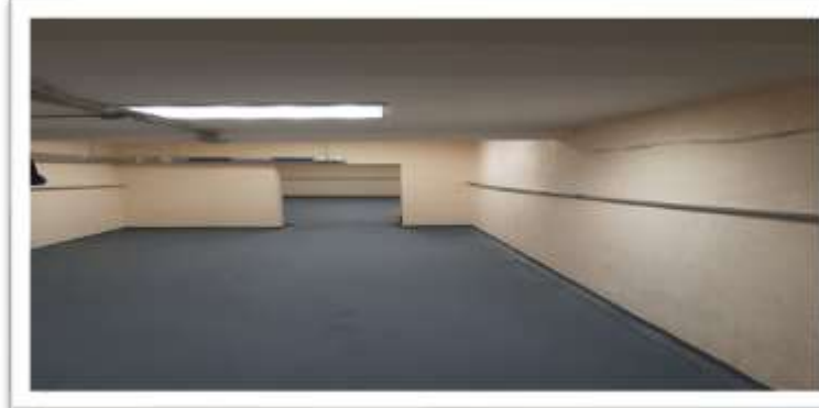
капітальний ремонт підвальних приміщень для використання під найпростіше укриття в житловому будинку на вул. В. Черчилля, 17
